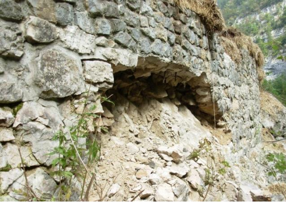
© B. Villemus – Pathologies d'un mur en maçonnerie
